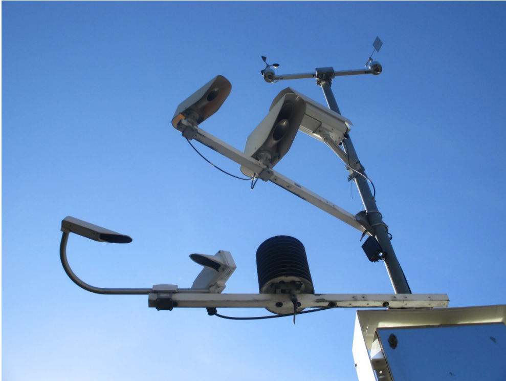
2.7.att. Sistēmas aprīkojums a/c A1 72.km
