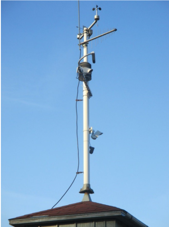
2.9.att. Sistēmas aprīkojums a/c A3 24.km
