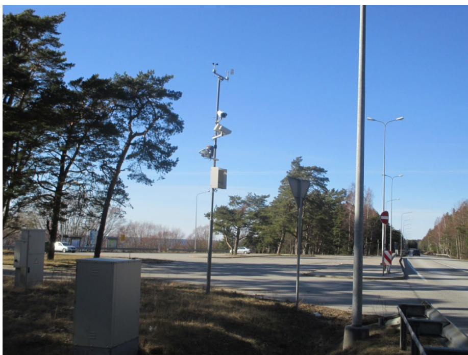
2.6.att. Sistēmas aprīkojums a/c A1 72.km
